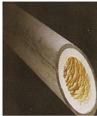
ketelsteen in een leiding.
